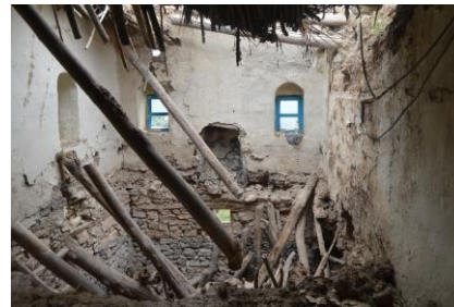
Foto-8: Zemin Kat, Sofanın kuzeybatısında yer alan yıkık mekan
