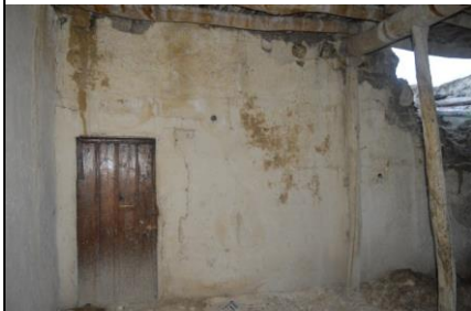
Foto-7: Zemin Kat, Sofanın kuzeybatısında yer alan yıkık mekanın girişi
