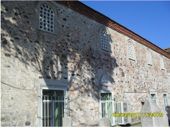
Resim 5. Onarımdan Önce Dış Cephe Pencerelerinin Genel Görünümü.
