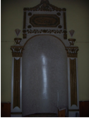
Resim 25. Mihrabın Onarımdan Önceki Genel Görümü
