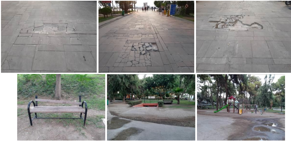
Şekil 6. Karaalioğlu Parkı'ndaki Bakım/Onarım İhtiyacı Olan Alanlar
