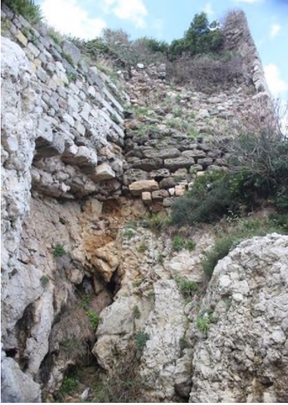
Şekil Hata! Belgede belirtilen stilde metne rastlanmadı.4: Bozetepe Kuzey Sur Hattında Bulunan ve Yıkılmakta Olan Burç Yapısı
