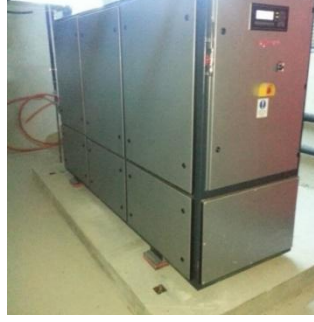
Şekil 6. SehaYapı’da kullanılan blok tipi mikro kojenerasyon ünitesi
