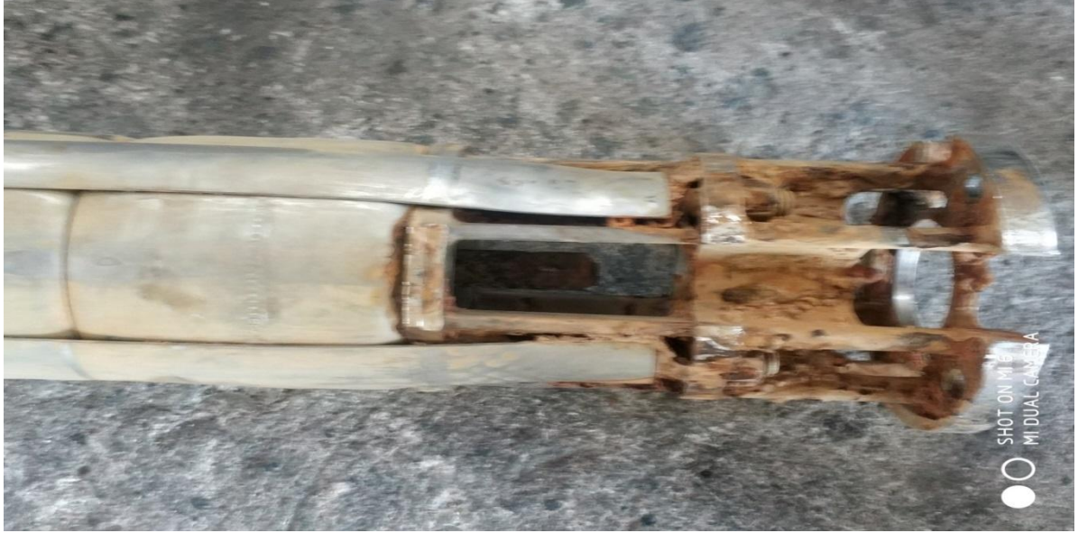
Şekil 6. Hatalı malzeme kullanımı sonucu kaplinin kopması
