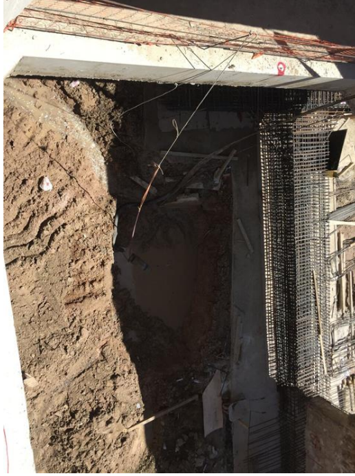
Şekil-5. Top- down inşaatında meydana gelen yeraltı suyu problemi
