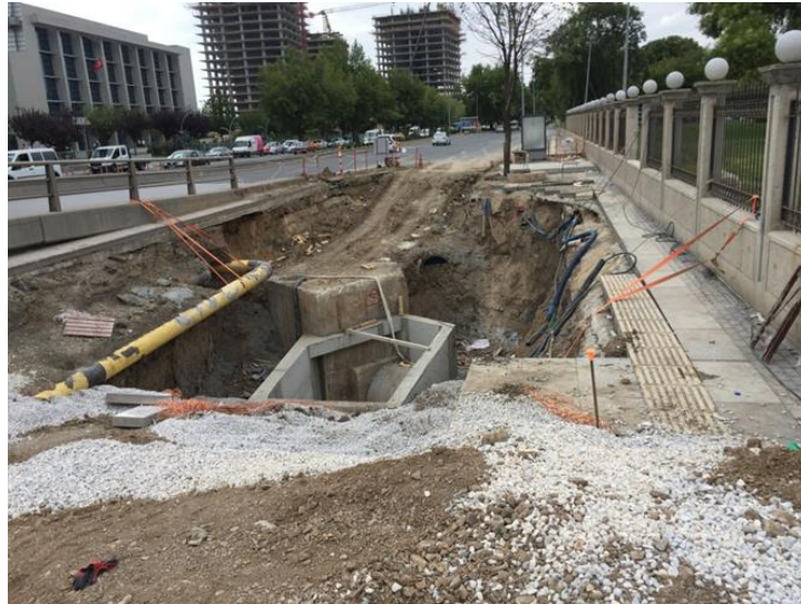
Şekil-4. Diyafram imalatı esnasında karşılaşılan yer altı hatları
