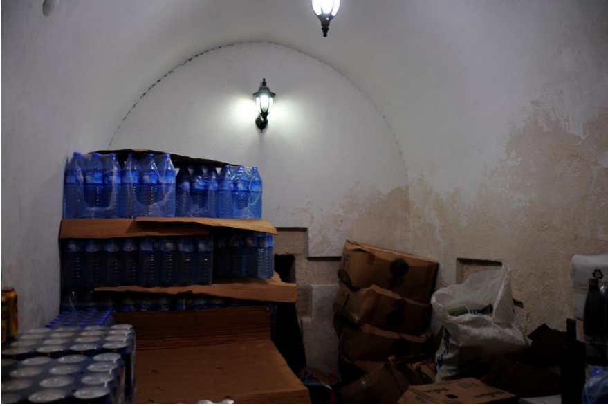
Fotoğraf 15. Hacı Sadık Ağa Hanı Zemin Kat Odalarının Güney Duvarı
