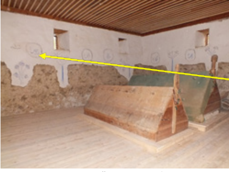
Şekil 38: Türbe Sıva Üstü Kalem İşleri (2012 restorasyonu öncesi)
