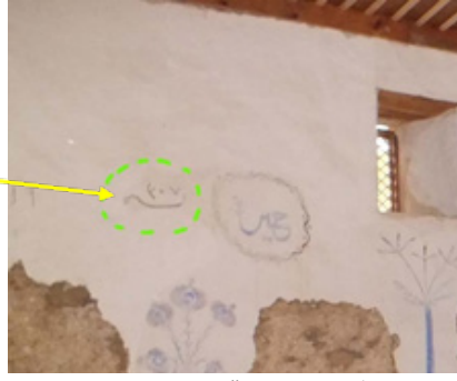
Şekil 39: Türbe Sıva Üstü Kalem İşleri (2012 restorasyonu öncesi)
