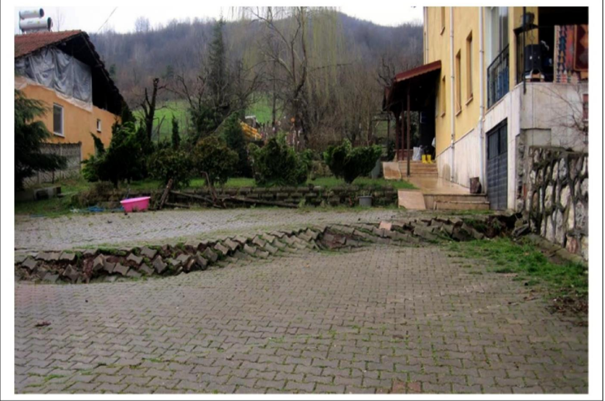
Şekil 4a. Mamuriye köyünde zarar gören yol ve bina [2].
