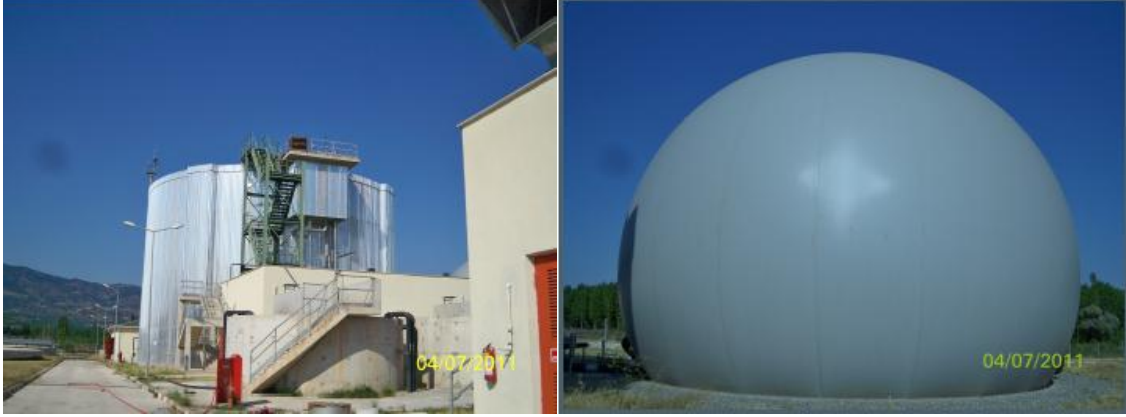
Resim 1: Çamur homojenizasyon tankı ve anaerobik çamur çürütme tankı Resim 2: Biyogaz depolama tankı
