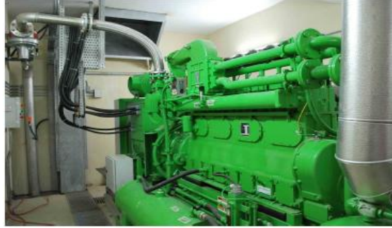
Resim 3: Tokat atık su arıtma tesisi kojenerasyon tesisi
