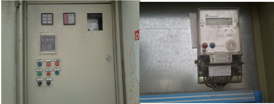
Şekil 4. Elektrik panosu ve elektrik sayacı.
