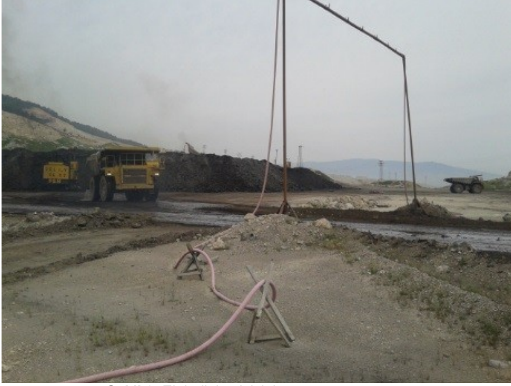
Şekil 3. Elektrik kesicisinin görünümü.
