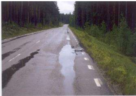
Şekil 2. Yolda oluşan tekerlek izi (Rutting in flexible pavement) [45, 46]
