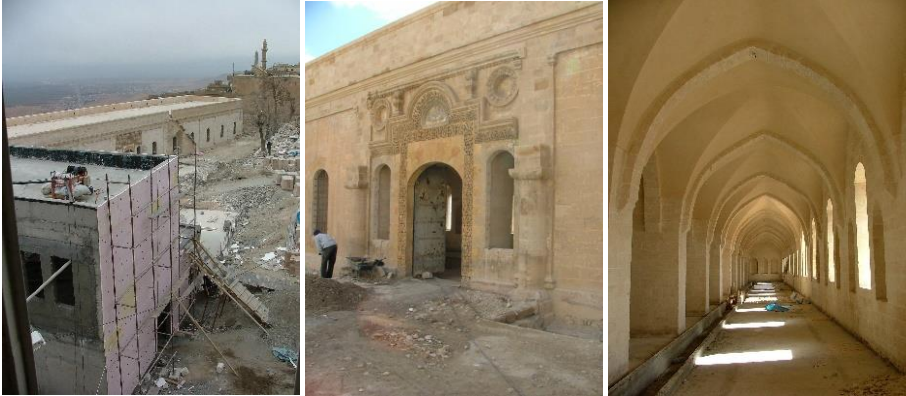
Resim 17, 18, 19. Sakıp Sabancı Mardin Kent Müzesi’nin restorasyonu sırasında, Kasım 2008-Ocak 2009 arasında çekilmiş fotoğrafları (Fotoğraf: Halil İbrahim Düzenli)
