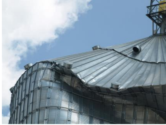
Şekil 19. Silo çatısının çökmesi (Collapse roof of silo)
