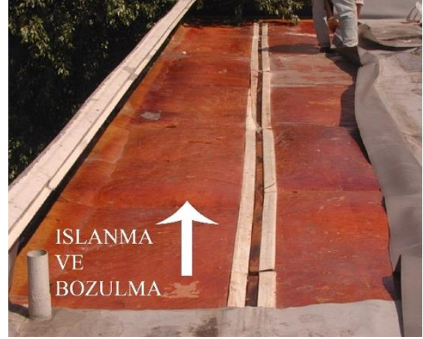
Şekil 6. Teras bir çatıda uygulanmış ısı yalıtım malzemesinin işlevini kaybetmesi (Güzelçoban, 2007)
