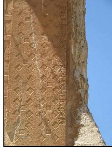
Res. 6: Anıtın Alt Kısımının Deformasyonu
