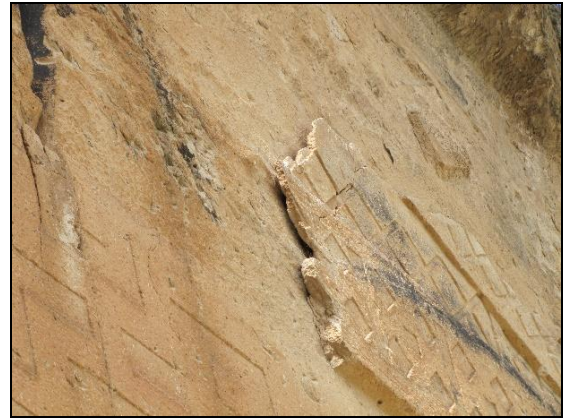
Res. 4: Alınlık Ana Kiriş Çatlak ve Parça Kaybı
