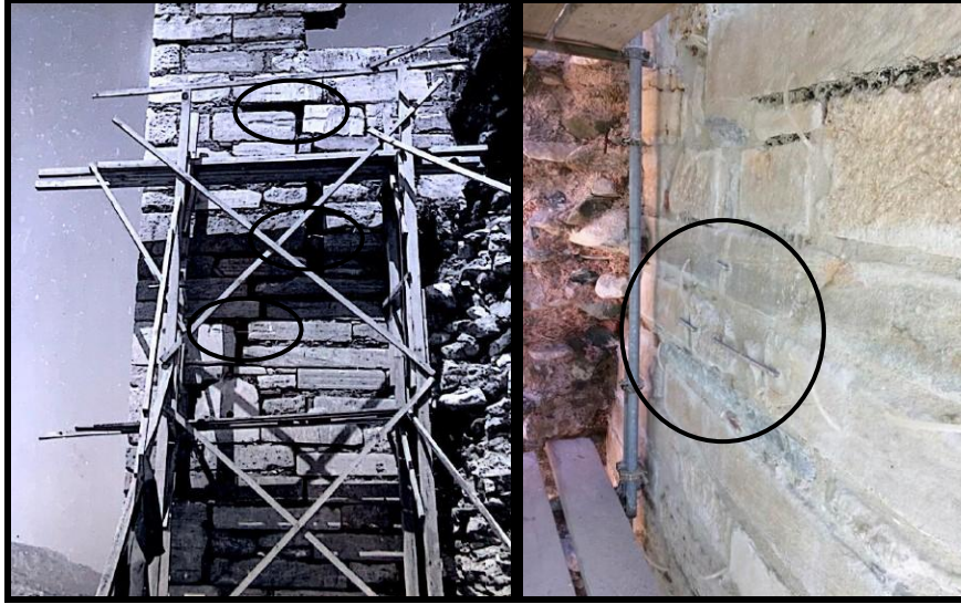
Res. 4: Solda Takip Kapısı Doğu Kule Doğu Cephede 1963 yılında yapılan demir kenetler (Baran 1963a, lev.12), sağda ise Takip Kapısı Doğu Kule Batı Cephede 2017 yılında yapılan enjeksiyon ve çelik kenetler (Kazı Arşivi).
