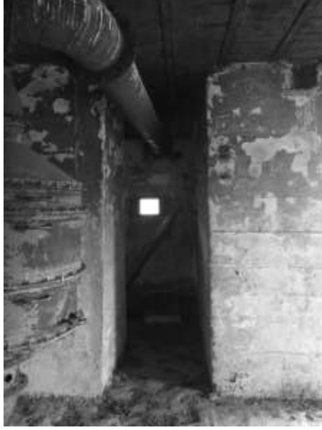
Ek 13. d. Havalandırma düzeneğinin dışarı ile bağlantısını sağlayan kalın boru aksamı.
