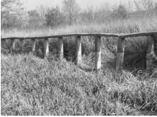
Ek 21. d. Bahşiyiş Köyü tankların geçişini engellemek için içinde demir bulunan birbirlerine bağlı ejderdişleri. Daha önce bu ejderdişlerinin önünde derin kazılmış bir hendek vardı. Ancak zamanla bu hendek dolduruldu.
