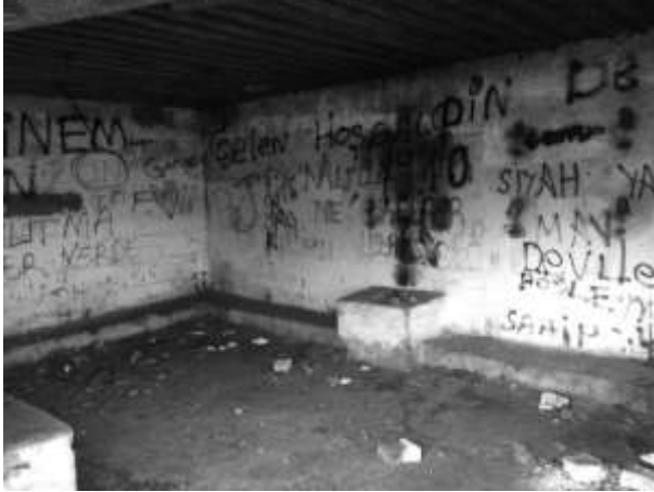
Ek 15. d. Büyükçekmece-Eskice Çiftliği yolu solda, göl kenarında üçüncü tip koruganın içi. Havalandırma sisteminin bütün demir aksamı sökülmüş.
