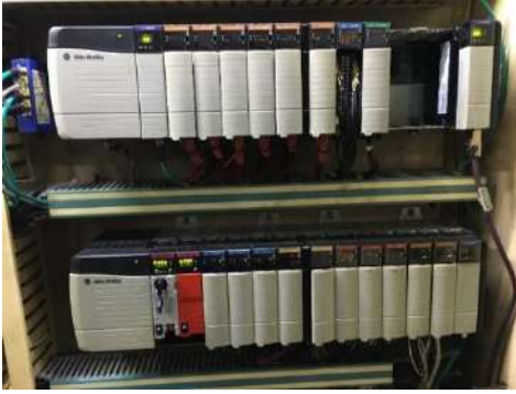
(b) PLC dönüşümü yapılmış kumanda sistemi
