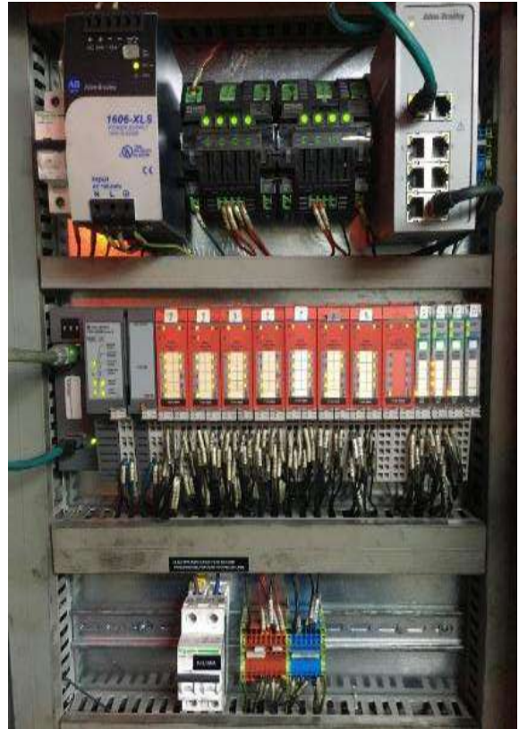
Şekil 8. Mill Makinesi güvenli PLC I/O paneli
