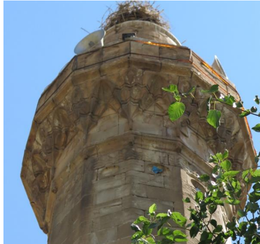
Resim 13-14. Üçgöz (Sofraz) Hasan Paşa Cami Minaresi ve Bacini
