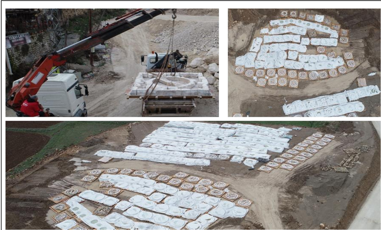
Resim 8. Hasankeyf Er Rızk Camii Minaresinin Sökümü Yapılan Birim Yapı Elemanlarının Taşıyıcı Platformların Üzerine Alınarak Depo Alanına Taşınması.
