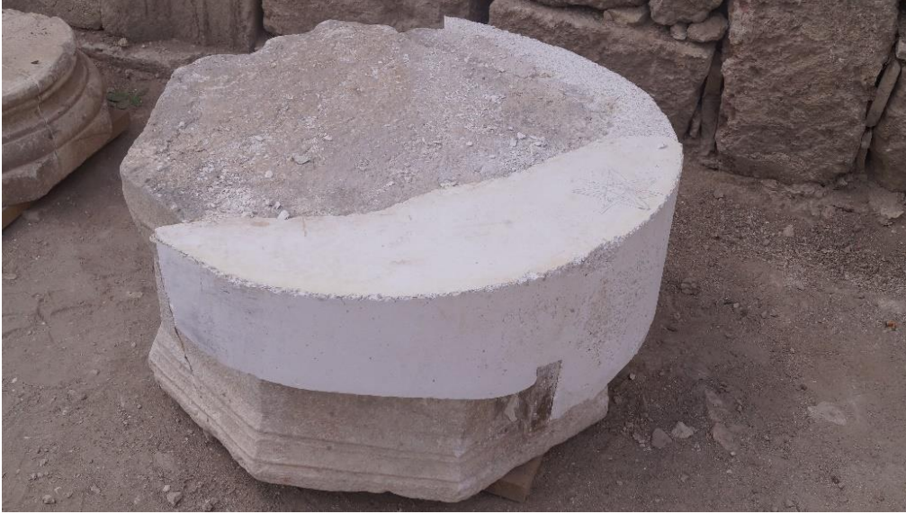
Şekil 6. Perge Antik Kenti Batı Cadde’de agrega ve kireç kullanılarak hazırlanan harç ile yapılmış bütünleme müdahalesi, kalıp sökümü sonrası durumu (Kafa Duran, E. Kişisel arşiv, 2017)
