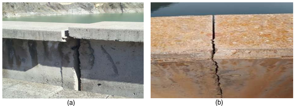
Şekil 6. Parapet duvarlarında oluşan çatlaklar
