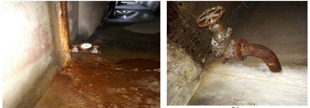
Şekil 5. Galeri içerisinde bakımsız durumda tesisat
