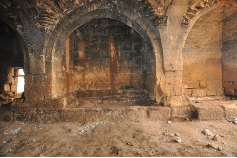
Şekil 40. Avlunun Güneybatı Tarafında Bulunan Koridor Şeklindeki Mekânlara Açılan Nişler ve Nişlerin Sekileri
