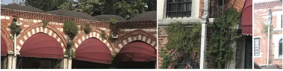
Görsel 29. Revak cephelerinde bitki oluşumu.
