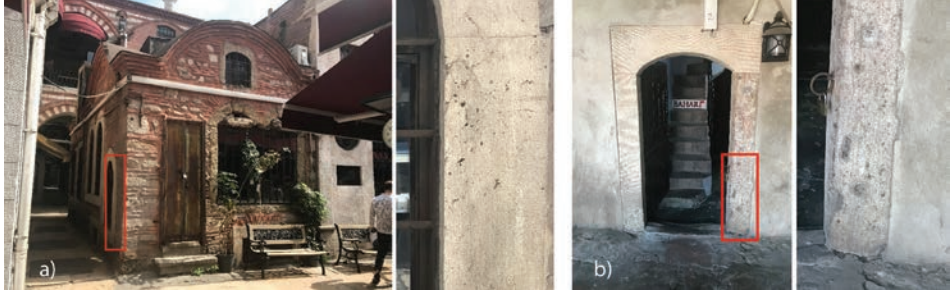
Görsel 24. a) Orta avludaki bir yapının pencere sövesi üzerinde. b) üst kat revakındaki bir dükkânın kapı sövesi üzerinde görülen çukurlaşma.
