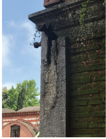
Görsel 31. Cumbanın yanındaki duvarda yosun oluşumu.
