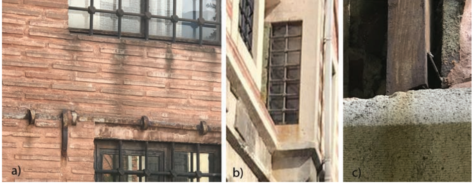
Görsel 26. a) Üst kattaki revakın doldurulmasıyla elde edilmiş cephede pas lekeleri. b) Güney cephede lokma parmaklıklar sebebiyle pas lekeleri. c) Avlu cephesinde paslanmış payandalar ve altındaki taşa lekelenme
