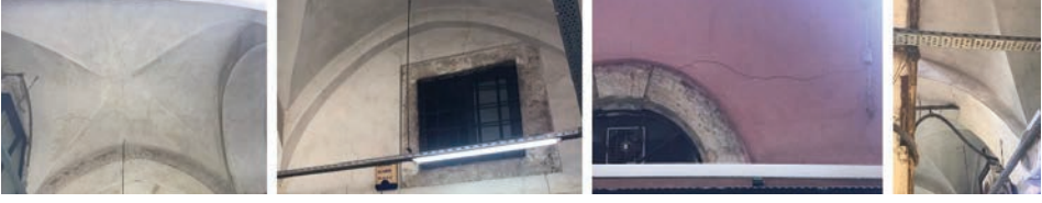
Görsel 19. Tonz, kemer ve duvar üzerinde görülen çatlaklar.
