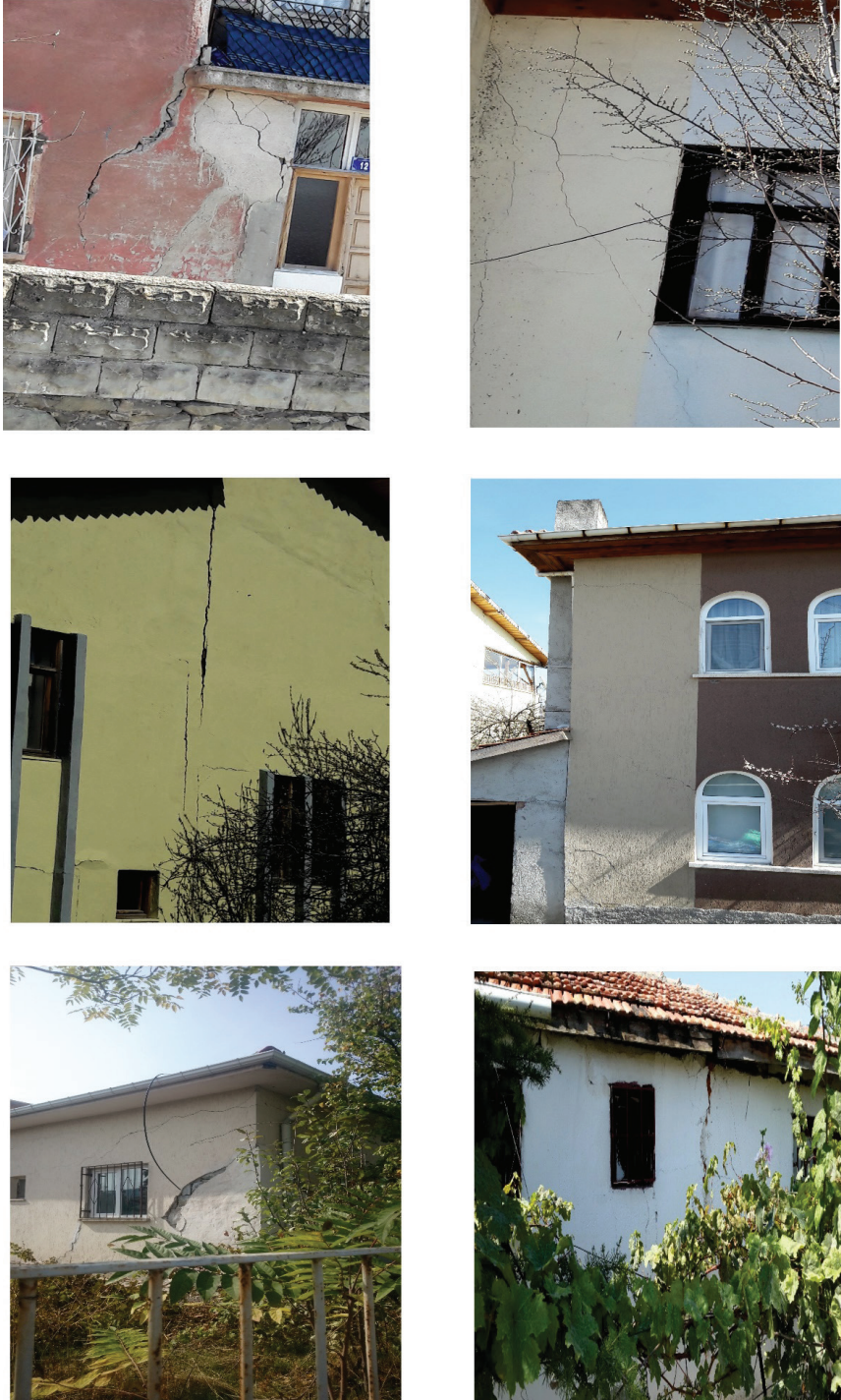
Şekil 1. Güdül yerleşim alanındaki binalarda izlenen çatlak oluşumları. Figure 1. Crack formations observed on buildings in Güdül settlement area.
