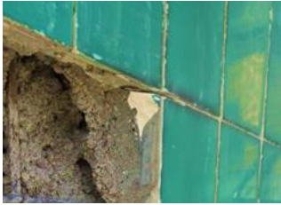
Şekil 2(b). Tahrip olmuş derz dolgusundan sökülen çini plaka altındaki çimento harcının görünümü
