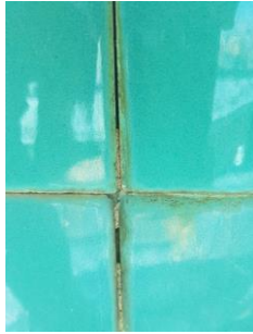
Şekil 2 (a). Günümüz Kubbe-i Hadra Gövde Çinileri arasındaki derz dolgularında oluşan dökülme ve derzlerde çözümlenmiş çimento harcı.
