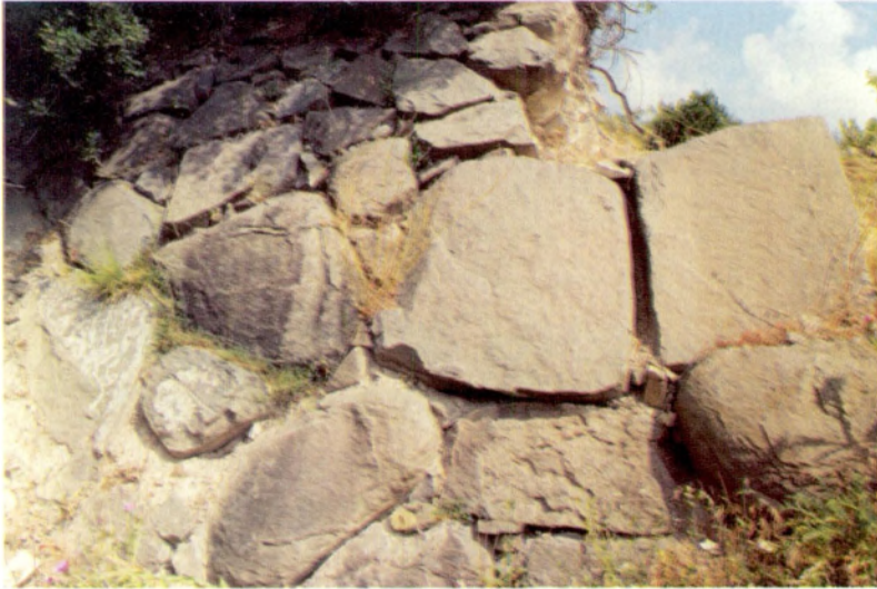
Res.16 - Kaçak kazılar sonucunda sur duvarında yapılmış tahribat, Akalan Kalesi
