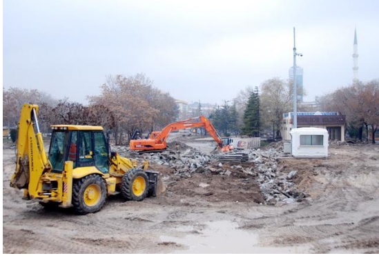
Şekil 17. Yıkılan kültürpark ve enkazları, 2008 (Şen, 2017)
