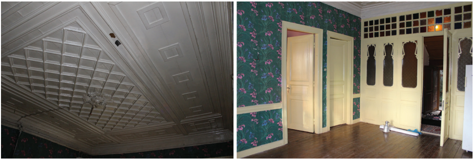
G. 6: Sunazırı Sokağı Köşkü Zemin Kat Sofasının Tavanı ve Bölücü Doğramaları (GTÜ Restorasyon A.B.D. Arşivi, 2018).
