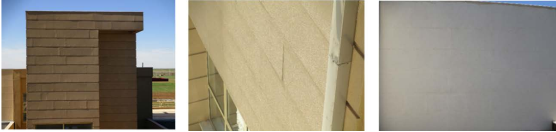
Şekil 2: Şanlıurfa Siverek 200 Yataklı Devlet Hastanesi cephelerinde sıva filesi imalatının donatı görevi görmemesi nedeniyle cephedeki bombe ve kalkmalar (Uygar Sarıaltın arşivinden; 2011)
