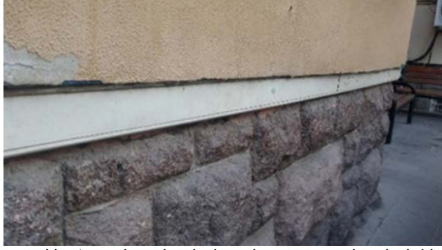
Şekil 4: Ankara Numune Hastanesi cephesinde subasman seviyesindeki özgün taş duvarlarda yalıtım ve boya uygulamasıyla oluşan bozulmalar
