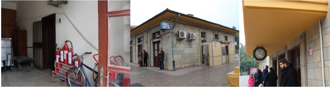
Görsel12 Yangın Söndürme Cihazları, Görsel13,14. Bina Cephesinde Grafik ve Yönlendirme Sistemleri
