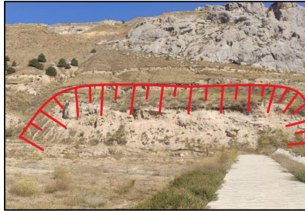
Şekil 8. Kayan bölgenin çalışma alanındaki görünümü
