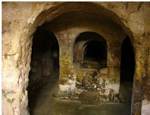
Şekil 12. Duvar yüzeyinde kimyasal değişiklik ile taşın tozlanması
