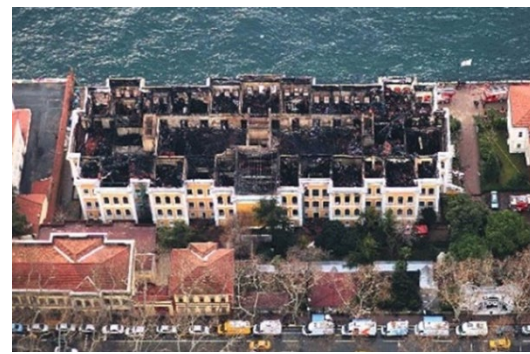
b. Yangın sonrası binadaki hasar
