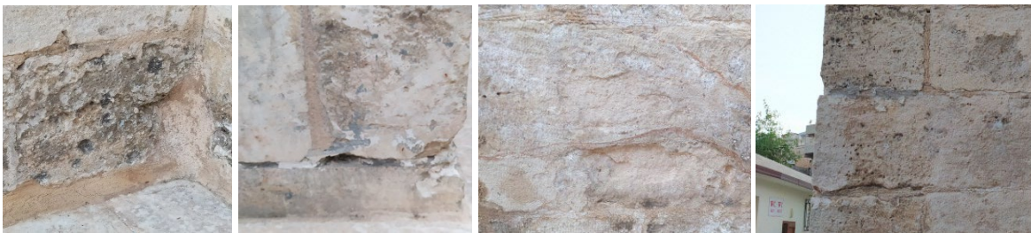
Şekil 15. Yüzey kaybı kaynaklı bozunmalar
