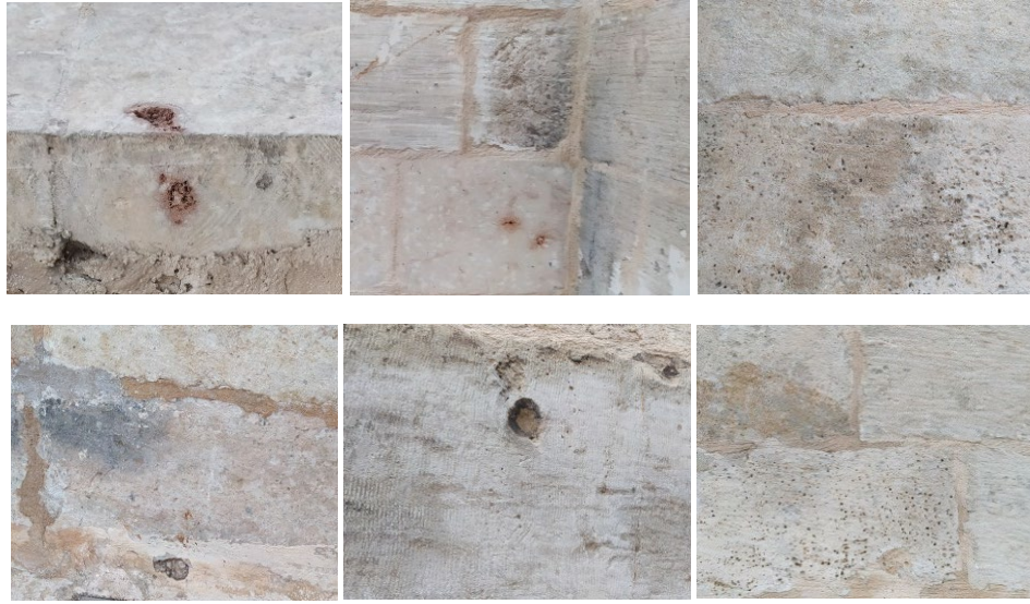
Şekil 22. Mikroorganizma oluşumu kaynaklı bozunmalar
