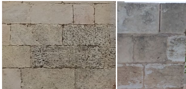
Şekil 17. Derz boşalması kaynaklı bozunmalar
