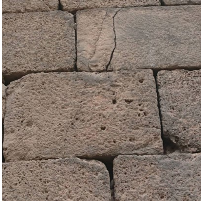
Şekil 14. Taş duvarda oluşan bünyesel veya zemin hareketine dayalı çatlak oluşumu
