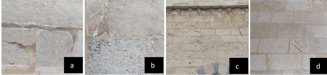
Şekil 13. Çatlak oluşumundan kaynaklı bozunmalar
