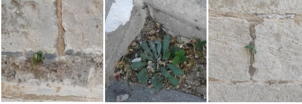
Şekil 21. Bitki oluşumu kaynaklı bozunmalar
