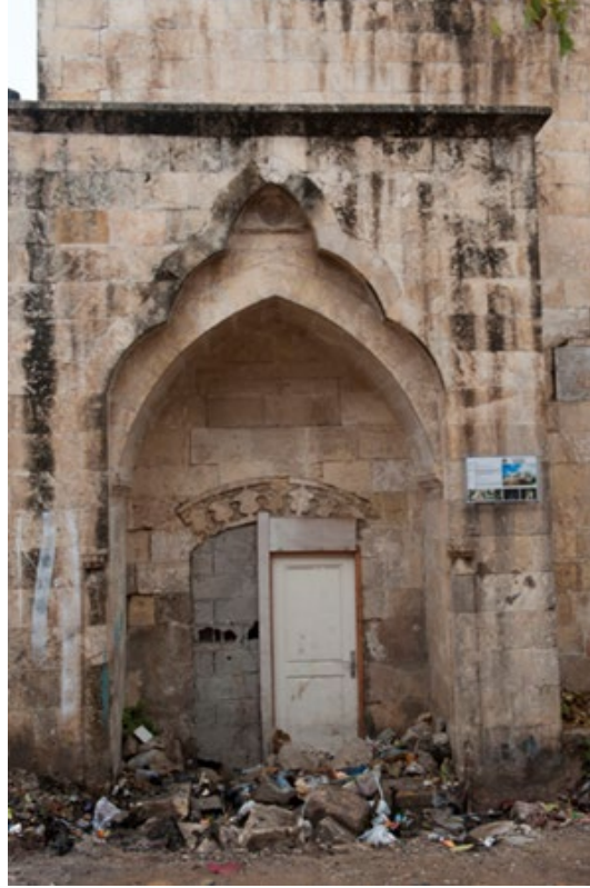
Şekil 21. Tarihi yapının çevresine çöp dökülerek zarar verilmesi
