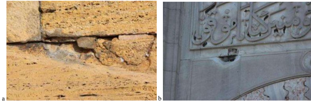
Şekil 17 a, b. Korozyon nedeni ile taşın yüzeyinden parça kopması (Çetin, 2012).
