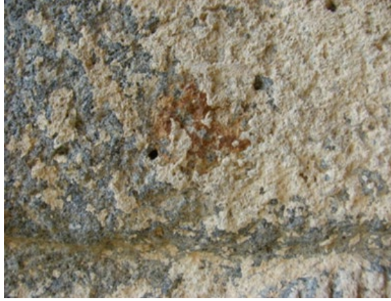
Şekil 18. Korozyonun yüzeyde oluşturduğu renk değişimi
