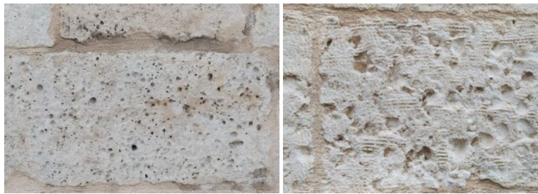
Şekil 14. Oyuklanma oluşumundan kaynaklı bozunmalar
