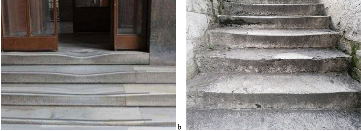
Şekil 15 a, b. Merdiven basamaklarının aşınması
