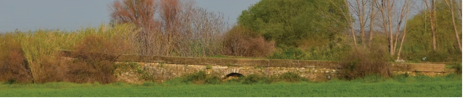
Fot. 1: Hüseyin Ağa Köprüsü; güney yakadaki kalıntılar. Mansap cephesi. (Bk. Şek. 1'de II ). (2018, E.Özbay)
