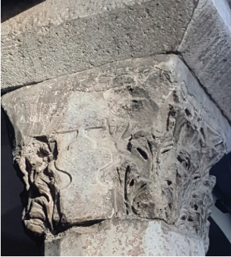
Fot. 9: İvaz Paşa Hamamında (15. yy) müdahale görmüş başlık
