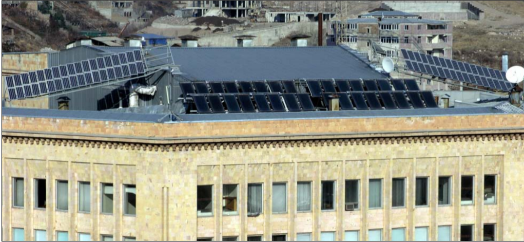
Foto 4. Amerikan Ermenistan Üniversitesi'nin Çatısında Güneş Panellerinden Bir Görünüm
