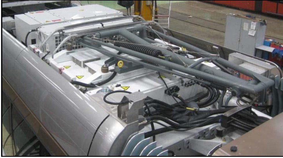
Şekil 15 Alstom Citadis Tramvayında NiMH Batarya Ünitesi (USTG, 2013)
