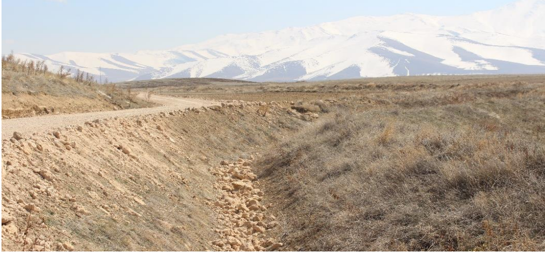
Şekil 8. Yol inşası nedeniyle tahrip olan kuzey kanat ve kanal içerisine dökülen inşaat malzemesi (Orijinal, 2019).
