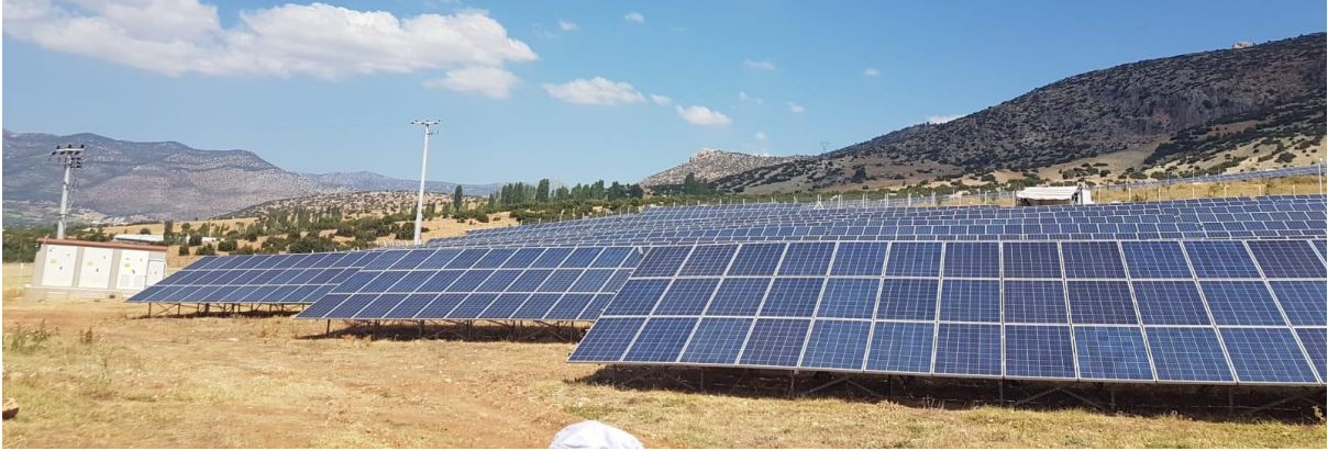
Şekil 1: Ölçümü yapılan güneş enerjisi santrali
