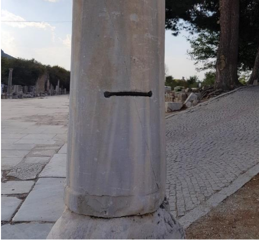
Şekil 1. Artemis Tapınağı'nda bulunan yığma taş bloklar üstündeki kenet uygulamaları.
