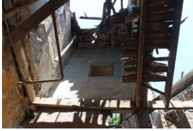
Resim 29: Yıkılan oda, içten görünüş
