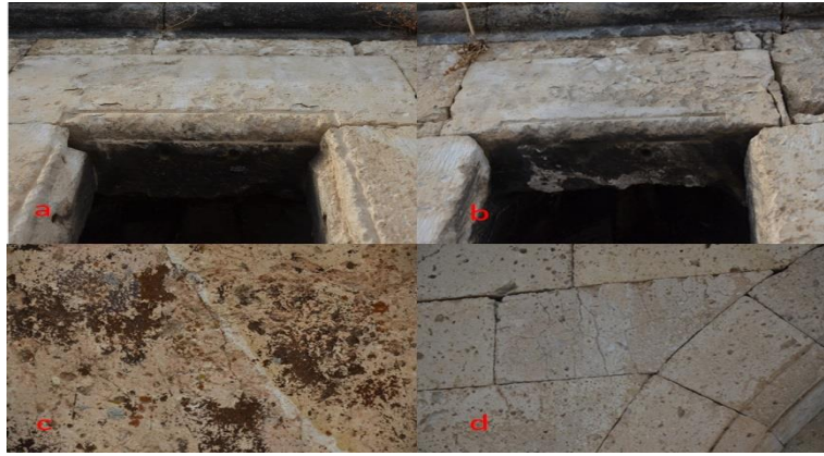
Fotoğraf 7. a-b. Kabuklanma, c-d. Çatlak oluşumu
