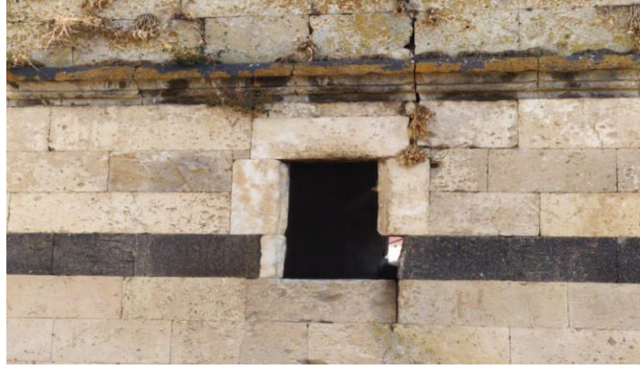
Fotoğraf 5. Batı cephesi birim malzeme kaybı
