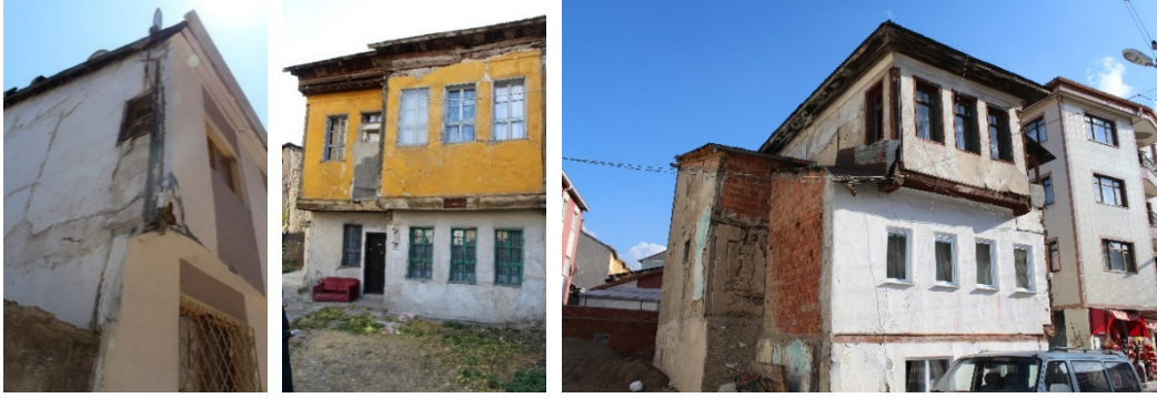
Şekil 26: Sivas geleneksel konutlarının yapı ölçeğinde korunma sorunları (sırasıyla: nitelsiz onarım; özgün açıklıkların kapatılması; yapının özgün yapısına aykırı malzeme kullanımı) (Gülhayat Kılıcı)
