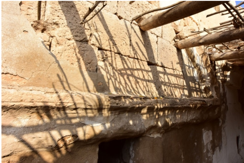
Fot. 23. Güney cephedeki eklentiler (Fot. Mardin Müzesi Arşivi).
