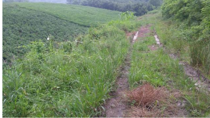
Şekil-32: Çay bahçesi ulaşım yollarının bakım ihtiyacı
