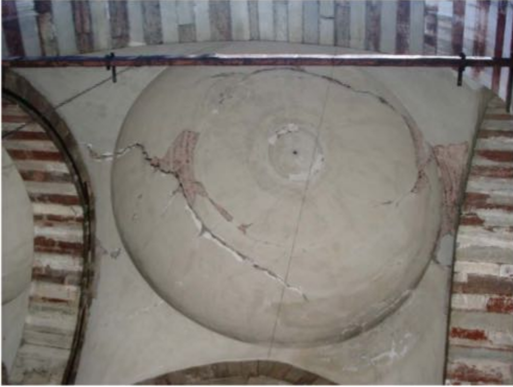
Şekil 6. Tarihi Yapılarda Deprem Kaynaklı Bozulmalara bir örnek: Fatih Külliyesi, İstanbul
