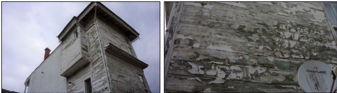
Şekil 13. Köşkün güney batı cephesi (Kaya, 2021) Şekil 14. Dış yüzeylerde bozulmalar (Kaya, 2021)
