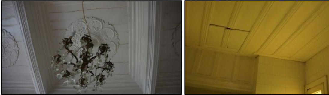
Şekil 17. Tavanlarda nemlenmeler (Kaya, 2021)
