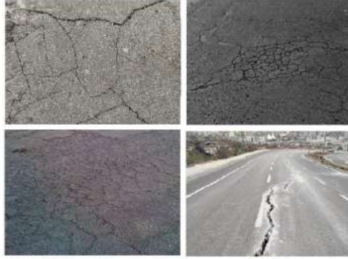
Şekil 1. Gerçek otoyol çatlak görüntüleri
