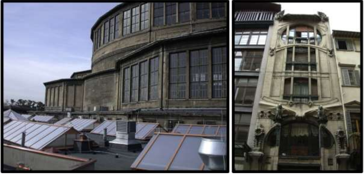
Őekil 1. Doęal ve insan etkisi ile dıř cephelerde oluřan kirlenmeler
