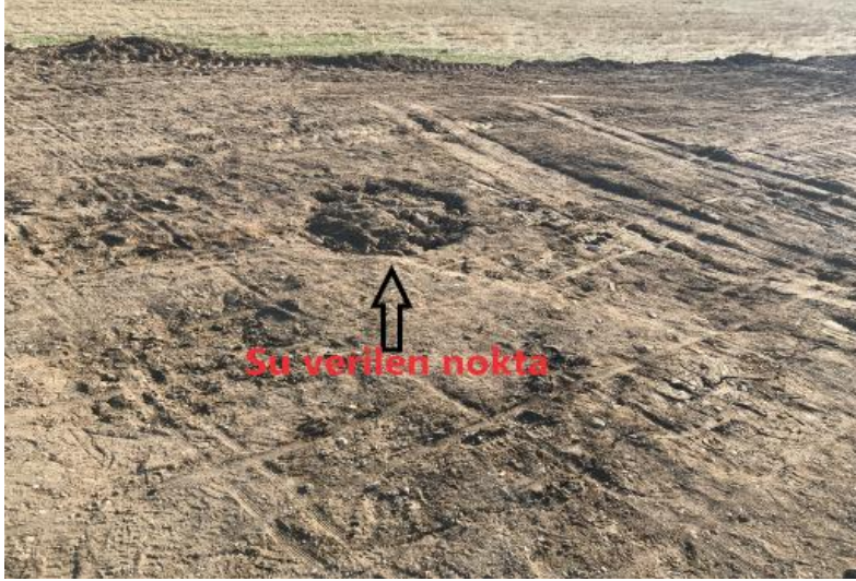
Şekil 7. Boruya su verilen nokta.
