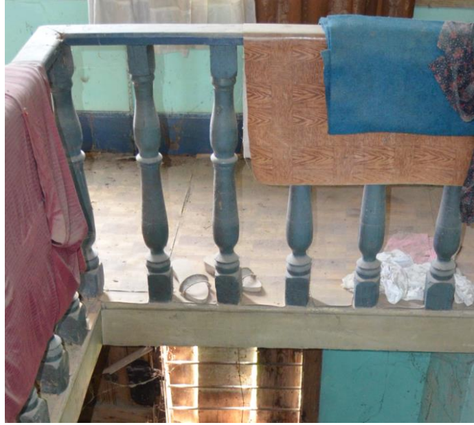
Görsel 43: Merdiven Korkuluk Detayı.
