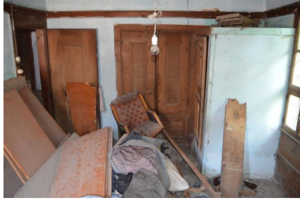
Görsel 19: Zemin Kat Sofanın Kuzeybatısında Yer Alan Mekânda Muhdes Banyo Bölümü.
