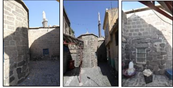
Şekil 7. Hoca Ahmet Cami güney cephe duvarında, aks kayması, harç kaybı ve ayrışma hasarları
