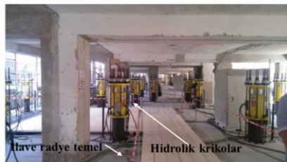
b) Taban izolasyonu yöntemi örneği: L'Aquila 2009 depreminde hasar görmüş betonarme konut binası
